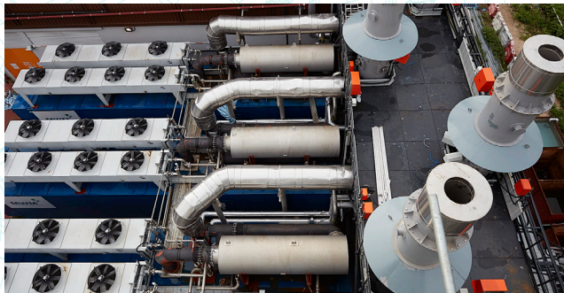
熱電聯產機組
