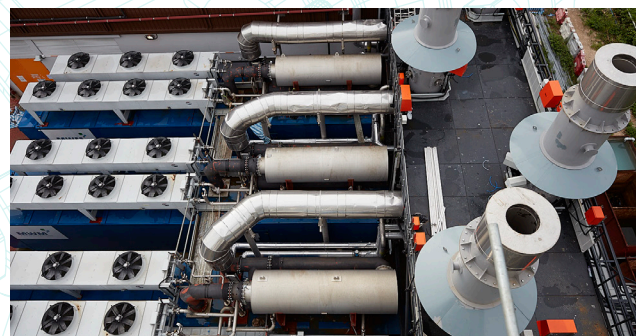
熱電聯產機組
